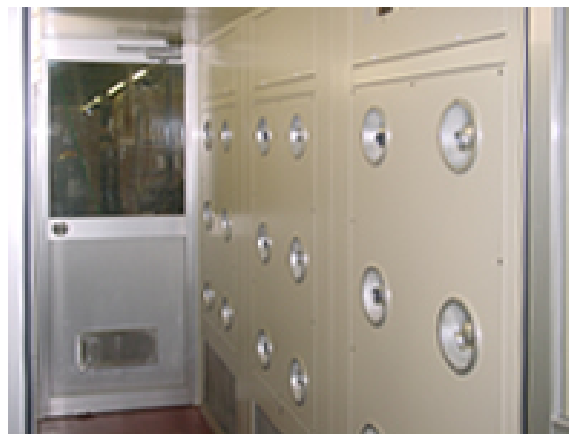
クリーンルーム
